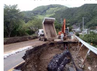
陥没道路現場
