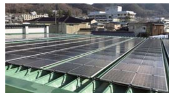
本社工場屋根太陽光発電
